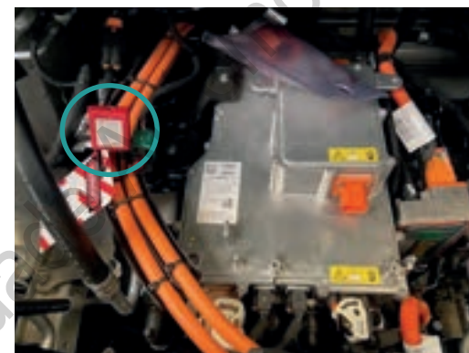
Exemplo de travamento com cadeado
